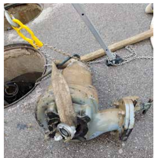
In der Kläranlage kam es zu Schäden an einer stationären und an 2 transportablen Pumpen und zu einem Defekt des Notstromaggregats.
