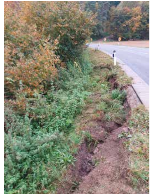
Schaden an einem Kanalrohr infolge einer Hangrutschung auf einer Länge von 24m
